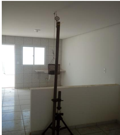
Figura 12 – Realização do ensaio de resistência de peças suspensas em forro de gesso
